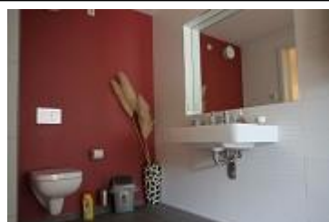
Waschbecken und WC entsprechend für Rollstuhlfahrer montiert
